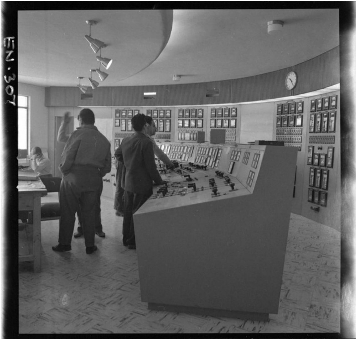
[Sala de comando, Central "Pullinque"] [fotografía] Luis Ladrón de Guevara.
