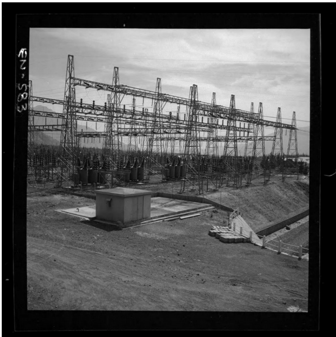
Aspecto del patio de alta [tensión] junto al edificio de la Central [fotografía] Luis Ladrón de Guevara.
